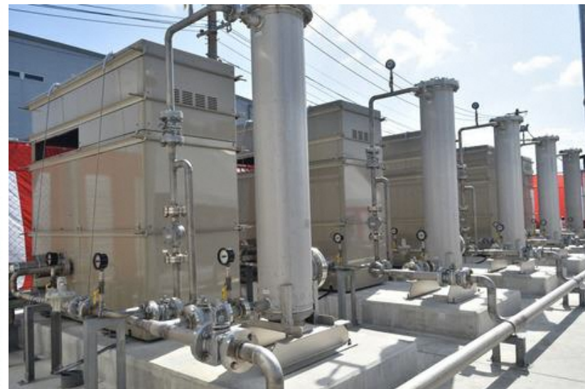
バイオガス発電設備
