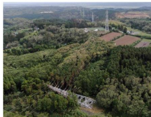
鉄塔設備の倒壊 (君津市)
