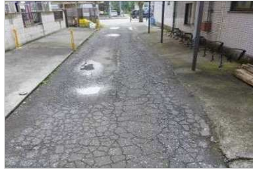
MCI=2.0 ひび割れが全面にひろがり、わだち 掘れが顕著
