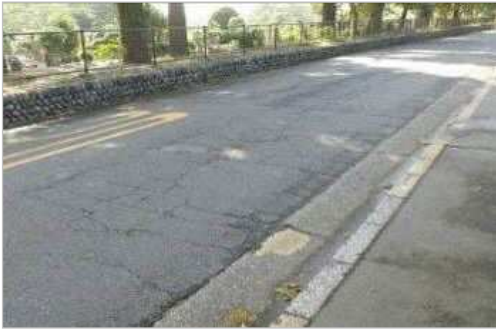
MCI=3.0 ひび割れが広範囲にひろがり、わだち 掘れが顕著
