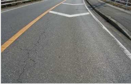
MCI=5.0 ひび割れが見える程度
