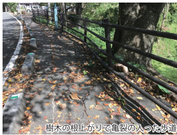
樹木の根上がりで亀裂の入った歩道
