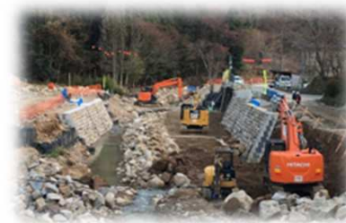
<災害復旧の状況>
