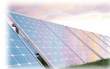
<太陽光パネル>
