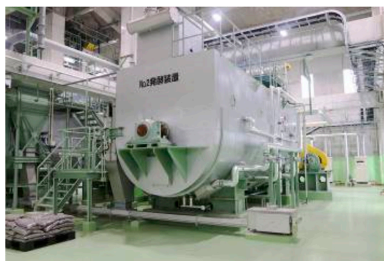
汚泥の発酵施設
