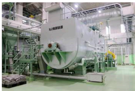
汚泥の発酵施設
