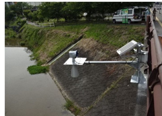
危機管理型水位計の設置事例 桂川(朝倉市内)
