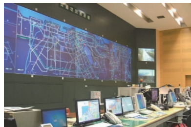
■図表-97 交通管制システム中央装置
