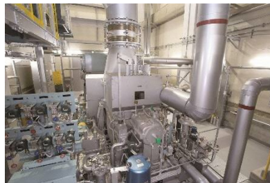
蒸気タービン発電機
