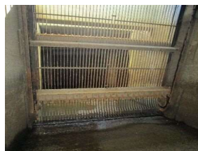
除塵機劣化状況
