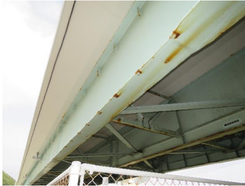
図解-8.2 足場吊りクランプ跡の再劣化事例
