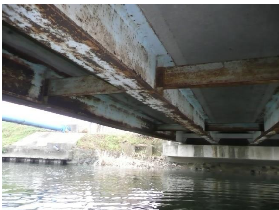
図 5 2011/2/11 (中間部, 塗替え 1 年経過)
