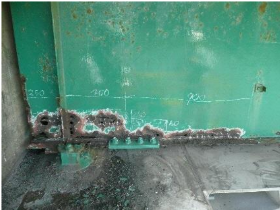
写真-1 損傷状況（Rc-Ⅲ 塗替え後 4 年）
