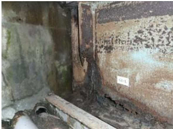
写真-1 損傷状況
