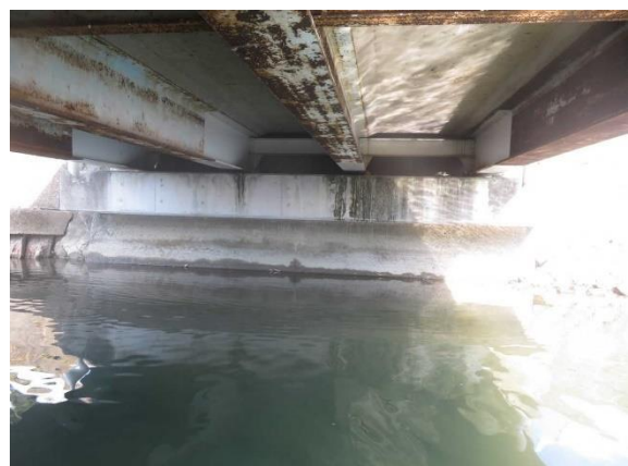
図 6 2021/12/15 (中間部, 塗替え 12 年経過)
