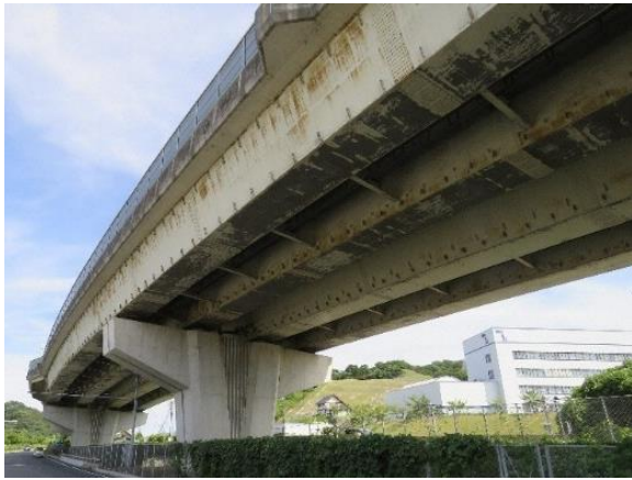
写真-1 塗膜剥離状況
