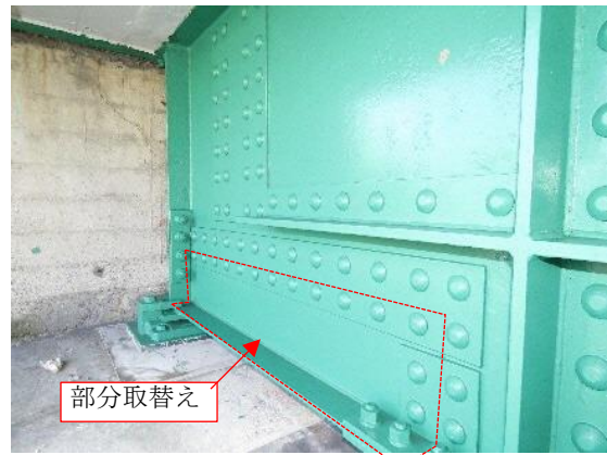
写真-2 桁端部補修構造（Rc-Ⅰ 塗替え後 1 年）
