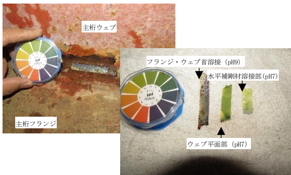
写真-2 損傷状況
