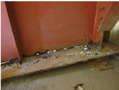
写真-1 下フランジとウェブ溶接部の腐食孔
