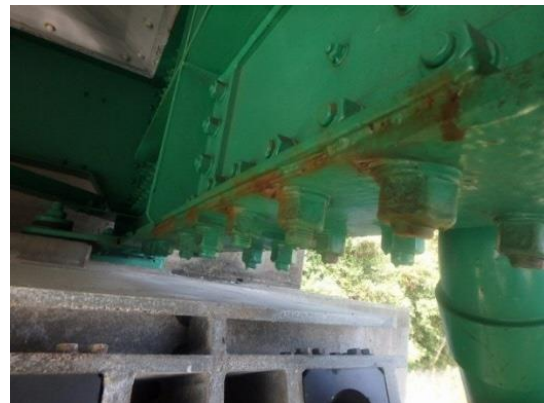
写真-3 桁端部の状況（Rc-Ⅰ 塗替え後 3.5 年）
