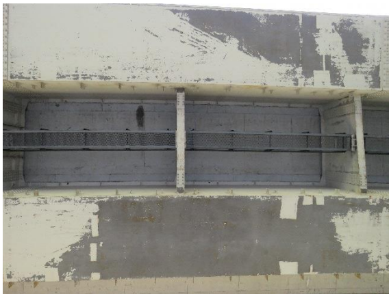
写真-2 塗膜剥離状況（下フランジ下面）
