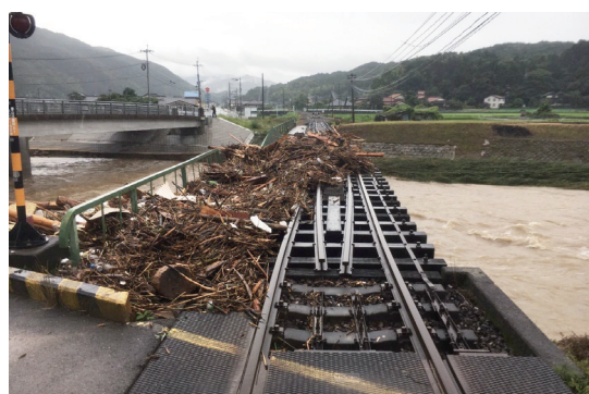
添田－歓遊舎ひこさん間（橋脚傾斜）
