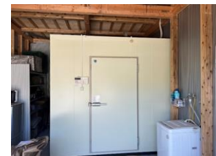
◀ 冷凍保存設備
