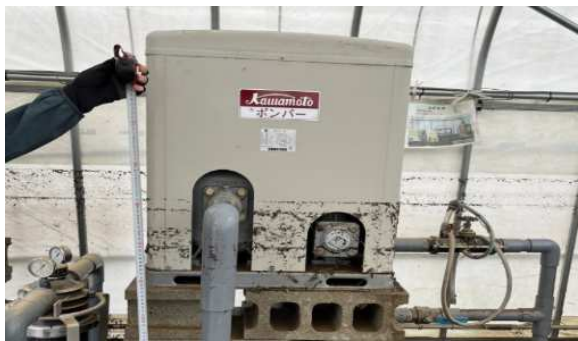
冠水した給水ポンプ (朝倉市)
