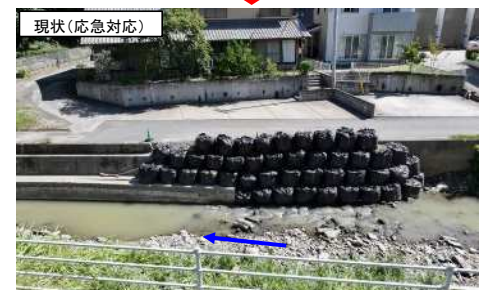
高良川(護岸崩壊) 久留米市
