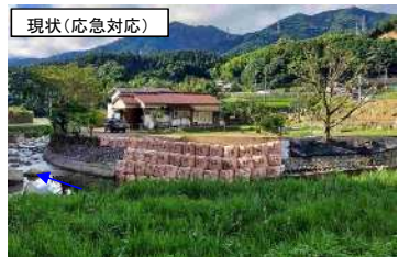
室見川(護岸崩壊) 福岡市
