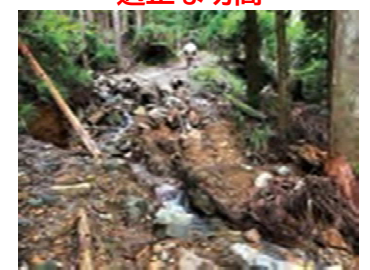
谷に盛土した作業道の崩壊
