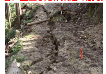
盛土で発生したクラック
