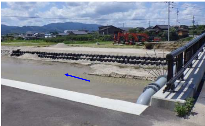
応急対策状況
