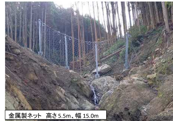
応急対策状況
