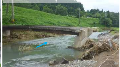
【被災状況 (南関町関町地内)】
