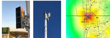
【防災スピーカー】市内24箇所に設置
