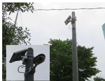
簡易監視カメラ設置(例)
