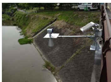
危機管理型水位計設置(例)
