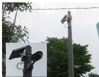
簡易監視カメラ設置(例)
