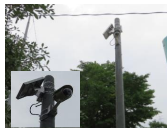
簡易監視カメラ設置(例)
