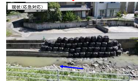
高良川(護岸崩壊) 久留米市
