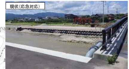
赤谷川(護岸崩壊) 朝倉市
