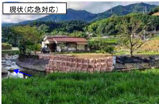
室見川(護岸崩壊) 福岡市
