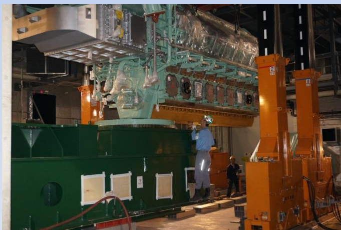
ガスエンジンリフトアップ 防振ベッド組込
