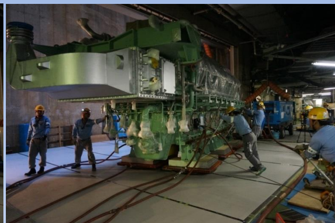
ガスエンジン エアパレット利用横移動
