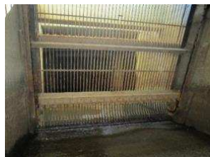
除塵機劣化状況
