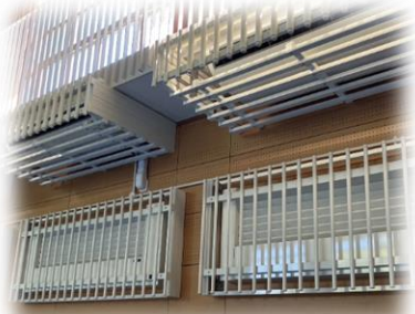
＜輻射パネル × パッケージエアコン＞
