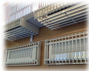
<輻射パネル × パッケージエアコン>
