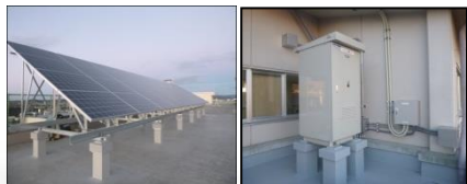
2011～2015 市内中核避難所に整備した PVと蓄電池(GND)
