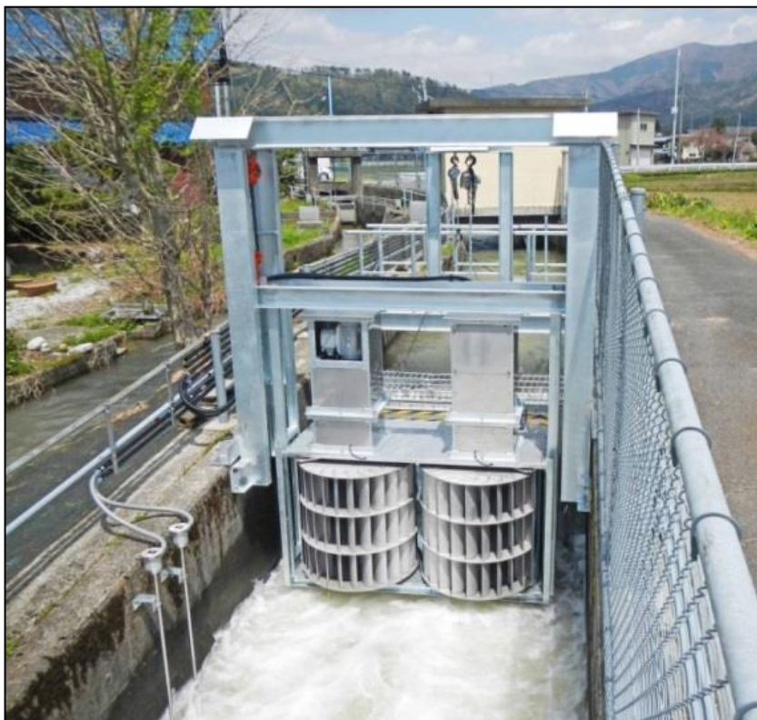
(小水力発電設備の導入事例)
