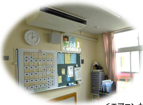
<エアコンが設置された教室>
