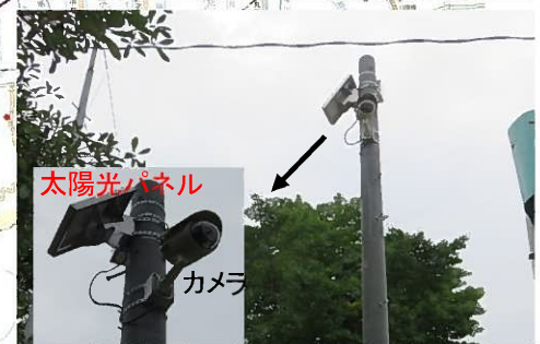
簡易監視カメラ設置(例)
