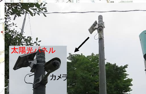
簡易監視カメラ設置(例)
