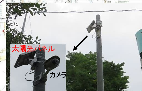
簡易監視カメラ設置(例)
