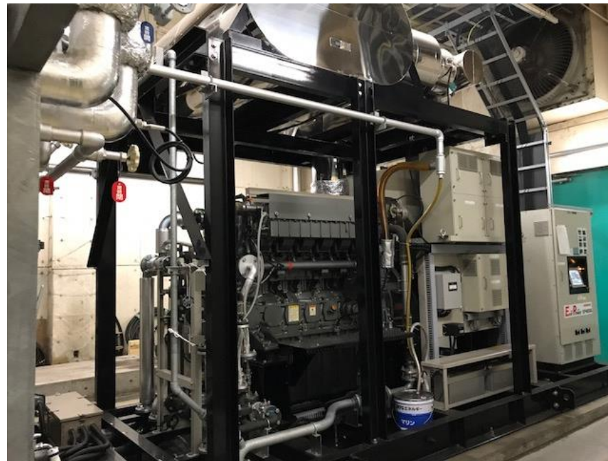
設置されているコージェネ設備（400kW）
