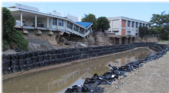
桂川の流水により被災した比良松中学校(朝倉市宮野)
