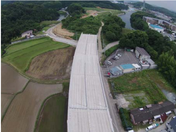
主要地方道 筑紫野古賀線 須恵・粕屋 2 工区 (須恵町～粕屋町)
