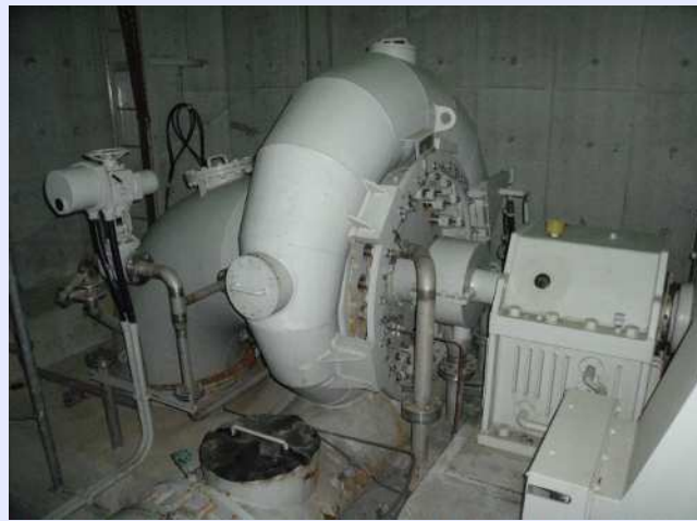
( 上写真は南畑ダムのフランスス水車発電機 )
