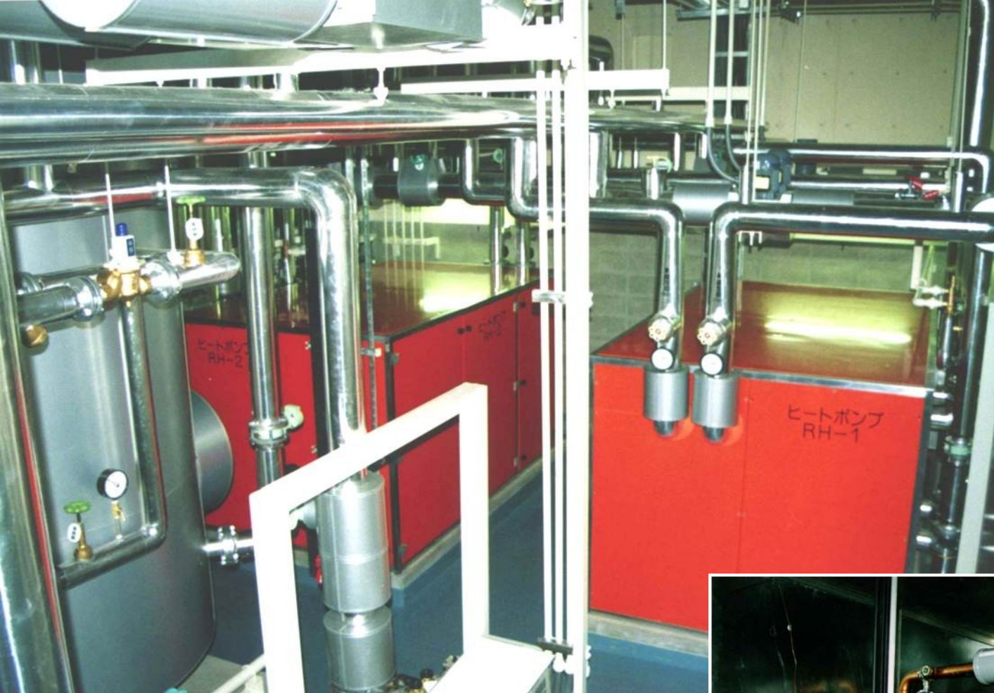
ヒートポンプとその内部状況
