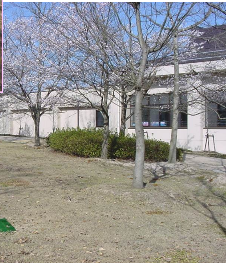
緑地に設置した地中熱交換器
