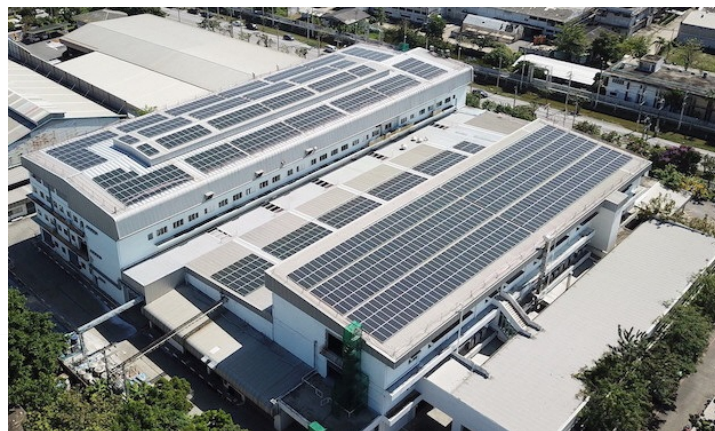
▲ 屋顶太阳能发电站的安装实例
