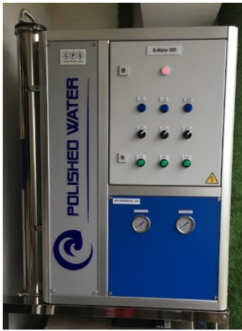
公寓楼的水质净化系统
