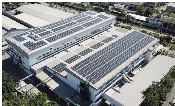
▲ ตัวอย่างการติดตั้งโรงไฟฟ้าพลังงานแสงอาทิตย์แบบติดตั้งบนหลังคา
