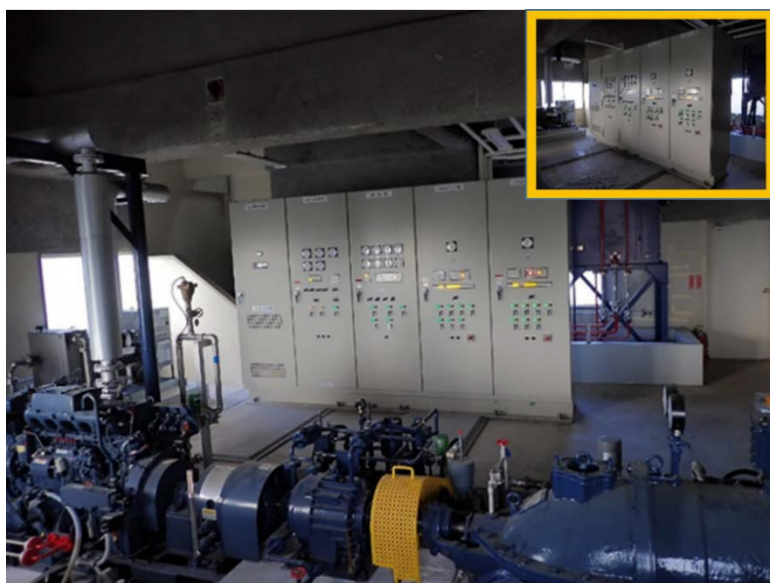
▲การนำระบบควบคุมเข้ามาใช้ในระบบบำบัดน้ำ
