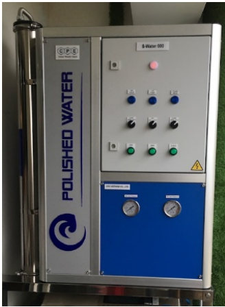
Hệ thống lọc nước ở khu căn hộ
