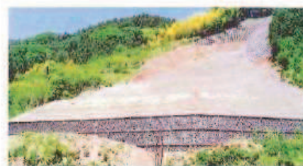
地すべり対策に用いられた鋼製砂防構造物
