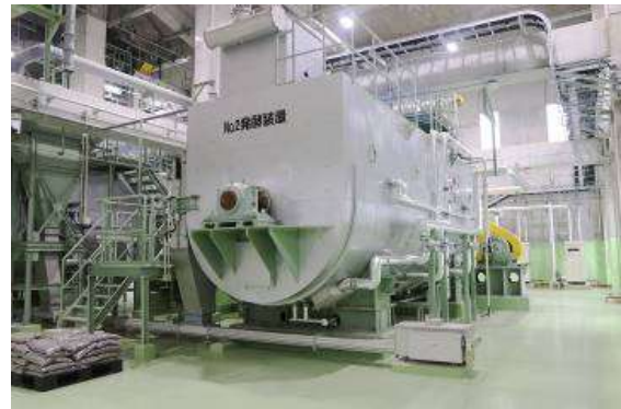
汚泥の発酵施設
