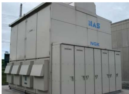
大型蓄電システム施設
