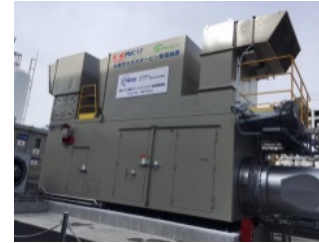
水素CGS (1.7MW)
