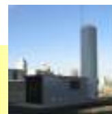
水素貯蔵タンク 水素吸蔵合金タイプ (30Nm 3 30kW相当)
