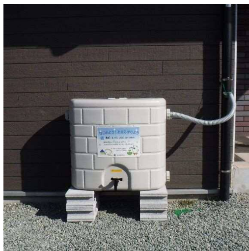
雨水タンクの設置状況
