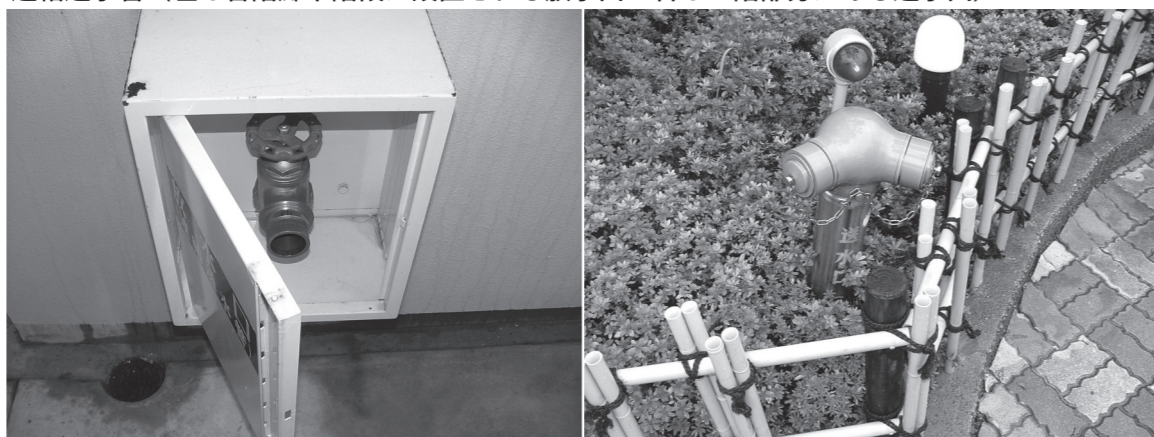
■連結送水管（左は各階廊下階段に設置される放水口 右は1階部分にある送水口）
