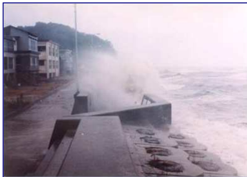
高潮・高波による越波 (行橋海岸長井北地区 福岡県)
