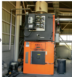
木質チップボイラー
