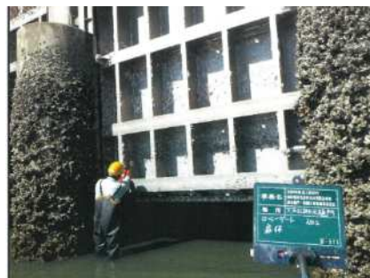
【排水樋門：ローラーゲート扉体】
